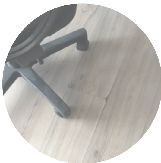
Piso sin la dilatación adecuada, y con sillas no aptas.
